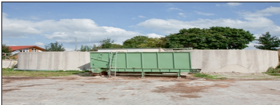
Fermenter Biogasanlage Lenz
