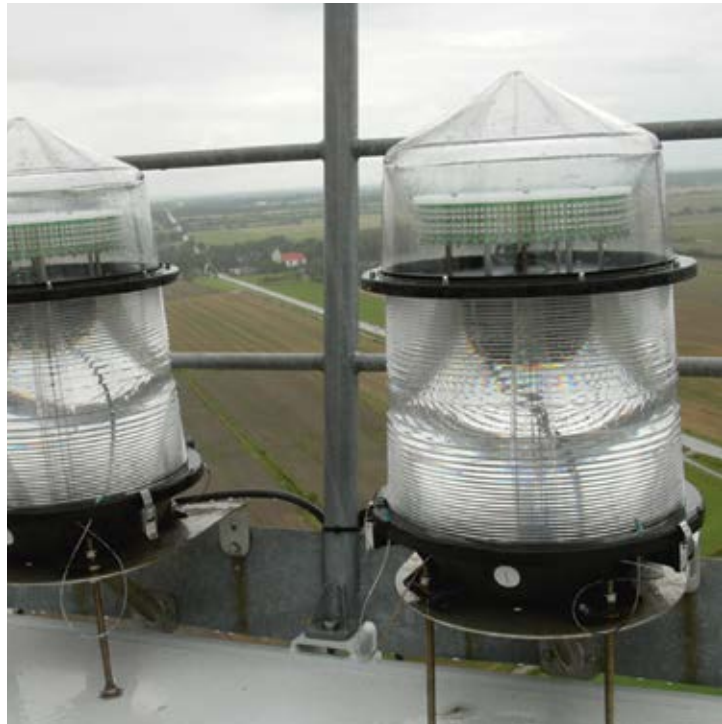
Hinderniskennzeichnung einer Windenergieanlage
